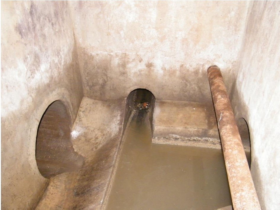
Abbildung 6: RÜ E2 (links: Entlastungsleitung zum Vorfluter)
