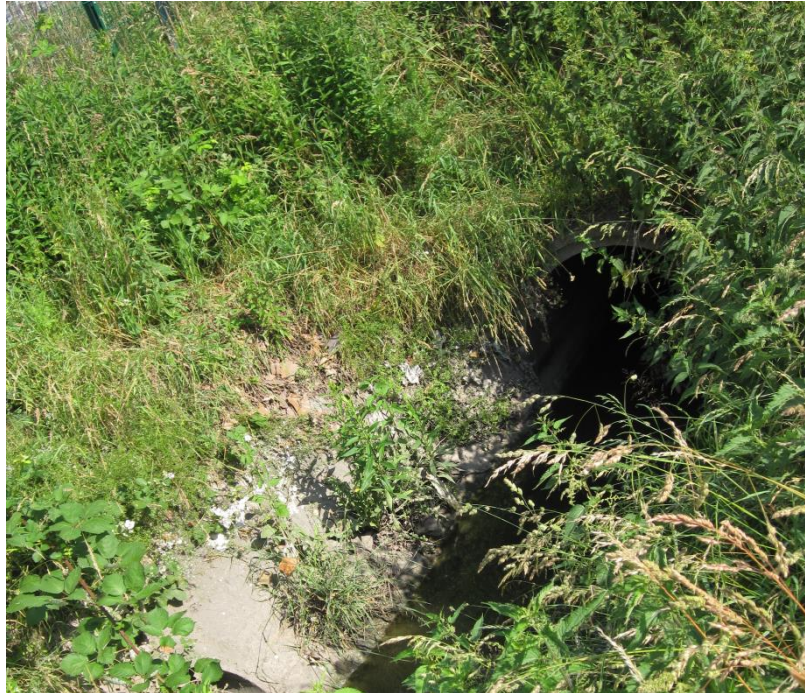
Abbildung 1: Ablagerungen von Schwimmstoffen im Endinger Graben
