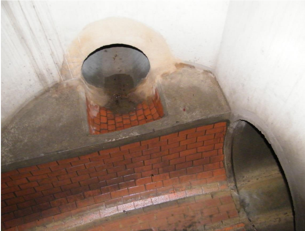
Abbildung 8: RÜ Königschaffhauser Straße (oben: Entlastungsleitung)
